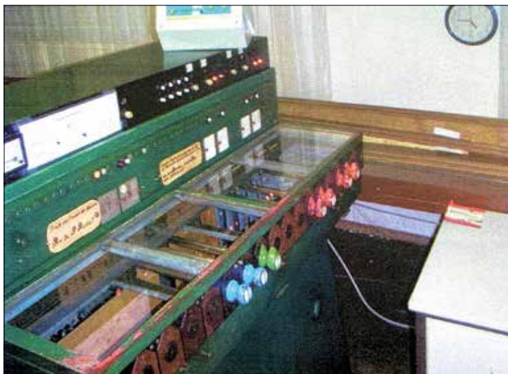
Elektromechanisches Stellwerk im Betriebsfeld des Bahntrainingszentrums Güstrow
