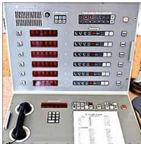
DB-Zugbahnfunk-Vermittlungsplatz aus den 1980er Jahren, Hersteller TELEFUNKEN Sammlung Tannigel
