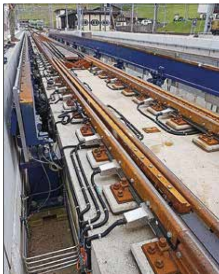
Umspuranlage in Zweisimmen – Die Außen-schienen dienen der Führung der Wagenkästen auf ausklappbaren Rollen. Mittig im Gleis liegen die Umspur-schienen für die Drehgestelle.
