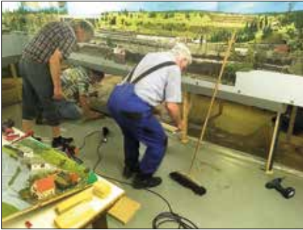
Horst de Haas und Adolf Till entfernen die vordere Verkleidung der Modellbahnanlage. Harald Hantschel untersucht darunter den feuchten Fußboden
