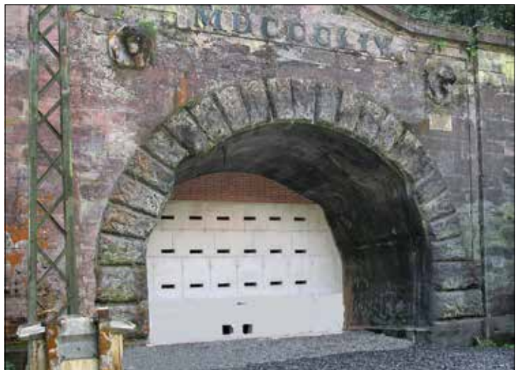
Zugemauertes Tun- nelportal Ost des ehem. Schwarzkopf- tunnels mit Fleder- mausdurchlässen, oben in römischen Ziffern das Baujahr 1854 Fotos: D. Rohrbach (4x)
