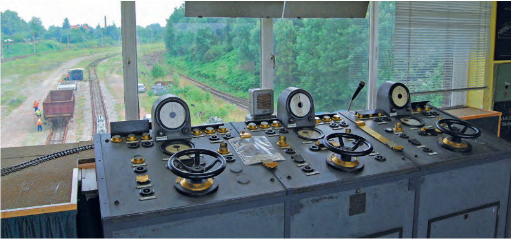
Restauriertes Bedienpult der Seilablaufanlage auf dem Befehlsstellwerk 3
